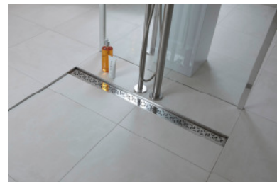
Duschrinne in keramischem Plattenbelag mit Gefälle zur Rinne hin.
